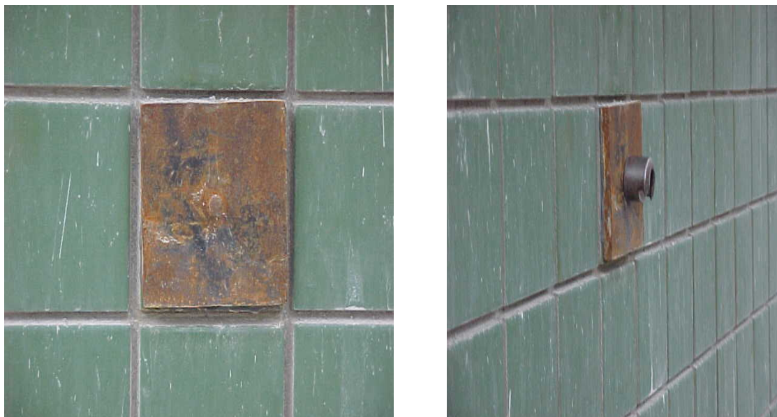
Fotografias 54 e 55 – Resistência a tração do revestimento
