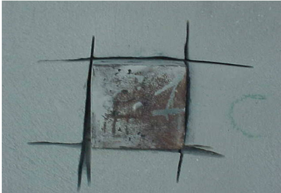
Fotografia 49 – Resistência a tração do emboço
